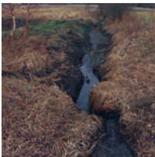
▲ Erosjon ødelegger elveløpet.
